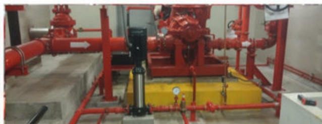
Cuarto de bombas.
