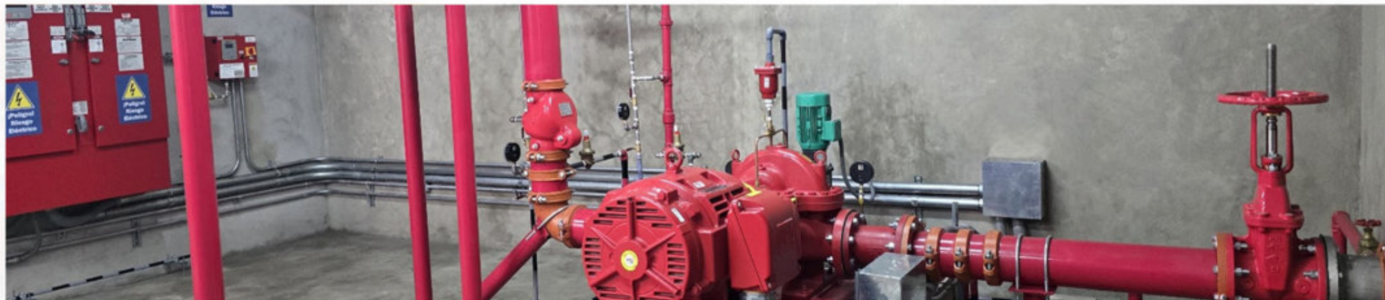
Cuarto de bombas del sistema contra incendios.
